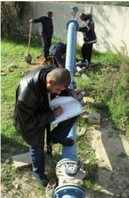
Foto: GTZ-Büro Jordanien Marode Leitungsnetze müssen erneuert werden
